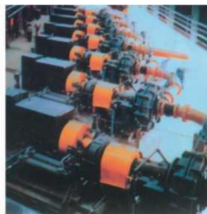
300DKB渣浆泵在电厂串联使用 300DKB slurry pump handling combined bottom and fly ash in a thermal power station. Применение шламового насоса 300DKB на электростанции в схеме последовательного включения
