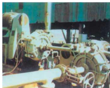
75DKHH渣浆泵在铁矿串联使用 75DKHH slurry pumps in series in iron mine plant. Применение шламовых насосов 75DKHH на железном руднике в схеме последовательного включения
