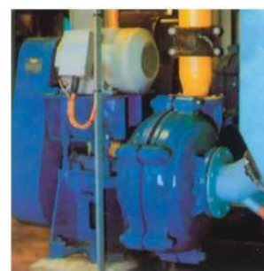
150DKB渣浆泵在洗煤厂的应用 150DKB slurry pump delivering fine coal to dewatering screen in a coal washery. Применение шламового насоса 150DKB на углеобогатительной фабрике
