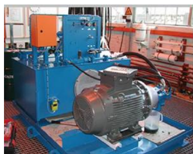
液压站 Hydraulic station Гидравлическая станция
