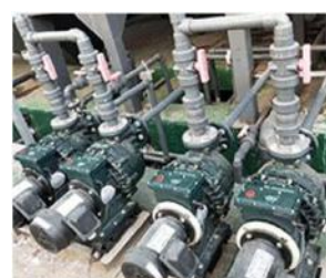
滤液泵 Filtrate pump Насос фильтрата
